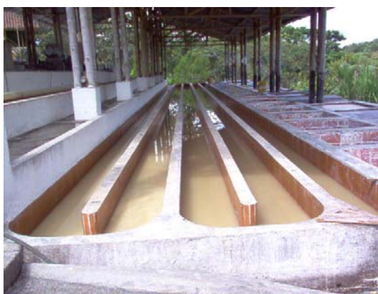
Figura 24. Canales de sedimentación de lechada de almidón.
