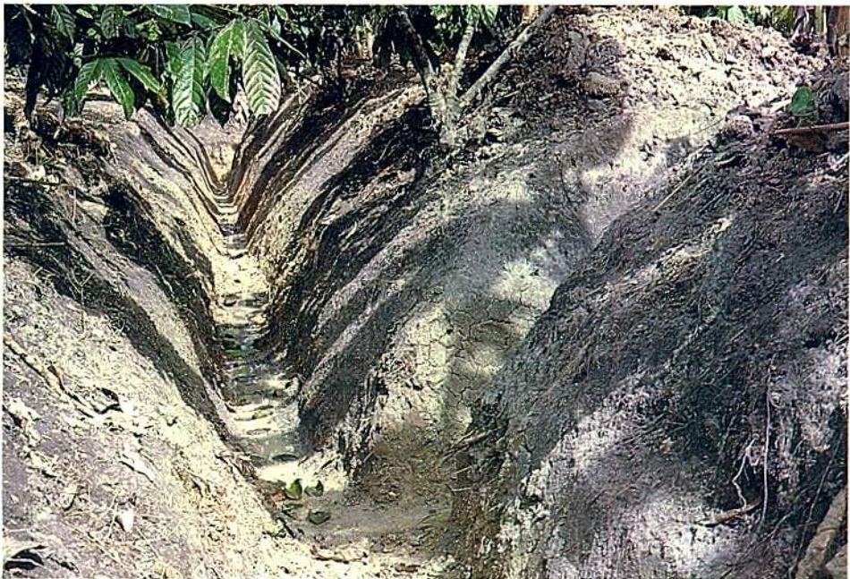
FIGURA 44. Las zanjas de desagüe se deben mantener en buenas condiciones de funcionamiento.
