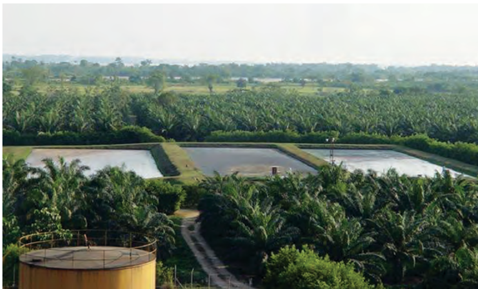
Figura 11 8 . Sistema de tratamiento de aguas residuales industriales.
