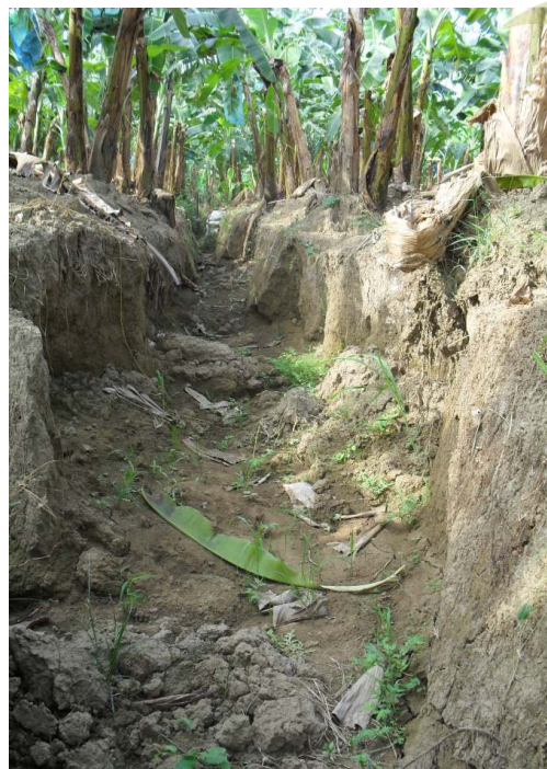
Figura 14. Formación de cárcavas en un canal de drenaje
