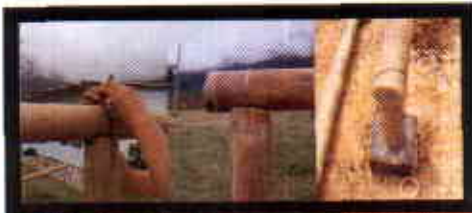
FIGURA 13. Detalles de los amarres hechos con grapas y alambre para la consolidación de la estructura.
