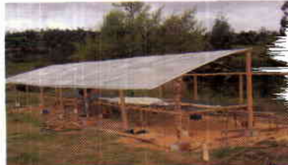
FIGURA 15. Ubicación montaje y templado del plástico de la cubierta superior en una de sus caras, las latas de guadua se emplean para presionar y soportar el plástico.
