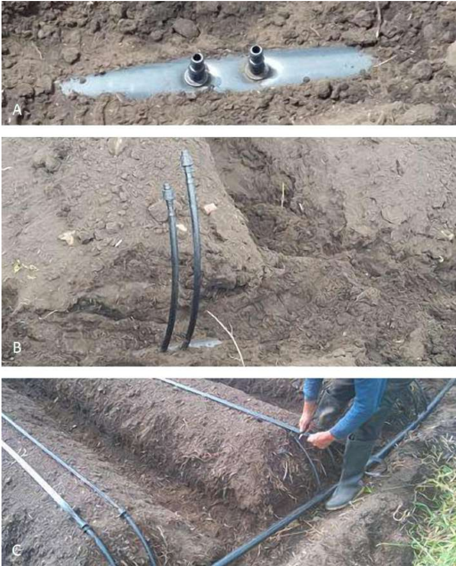
Figura 4 Tubería principal con silletas (a), manguera con conectores cinta (b) y doble cinta de riego sobre las camas (c).
