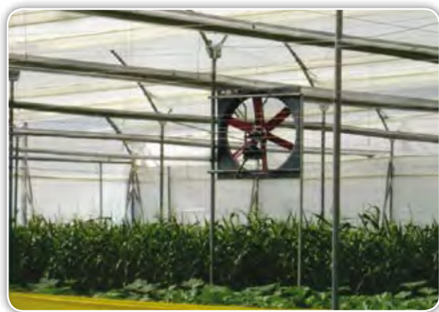
Figura 2.11. Ventilador para facilitar la circulación del aire
