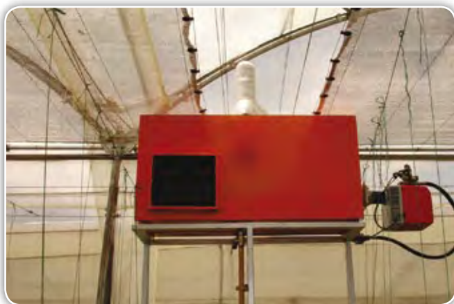
Figura 2.18. Sistema de calefacción por aire caliente
