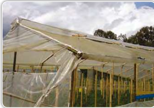
Figura 4.12. Acumulación de polvo sobre el plástico en un invernadero
