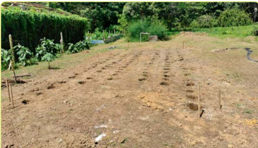
Figura 4.3. Ahoyado para la instalación de zapatas para cama central, mesas laterales y la estructura del túnel.
