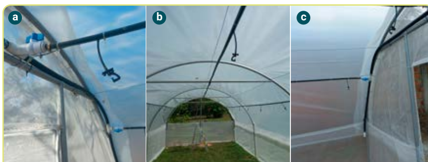
Figura 4.24. Instalación de tres líneas de microaspersión y del tapón de lavado. a. Detalle de las tres líneas; b. Distribución general; c. Tapón de lavado.
