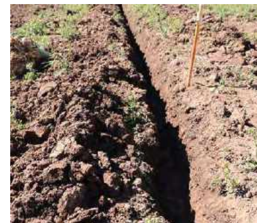
Figura 23. Sistema de drenaje para manejar los problemas de saturación hídrica. Foto: Ivonne Tristancho.
