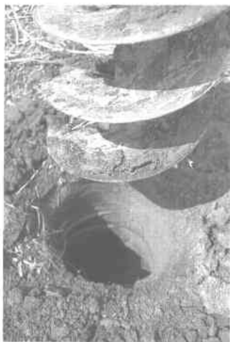
Figura 30. El hoyador mecánico, herramienta indispensable en zonas con déficit de mano de obra y suelos demasiado compactos y secos.
