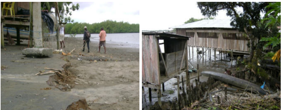
Figura 2.10. Escarpes de erosión en las playas de Charambirá (izquierda). Viviendas palafíticas que antes estaban en tierra firme en Pichimá, hoy están encima del mar debido al retroceso de la línea de costa (derecha).
