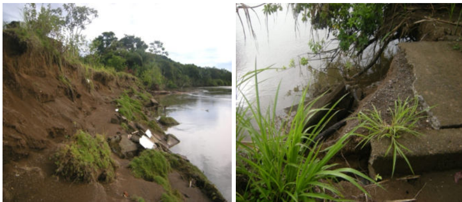
Figura 2.5. Erosión del talud de la superficie donde se encuentra localizado el cementerio (izquierda). Remanente de un acceso de cemento que conducía al cementerio que colapsó debido a la socavación por parte del río (derecha).
