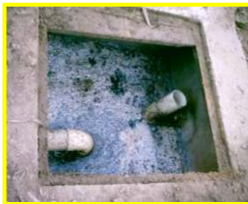
Foto 6. Vista en planta de una trampa de grasas.
