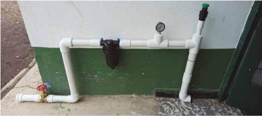
Accesorios utilizados en la construcción del módulo de riego.
