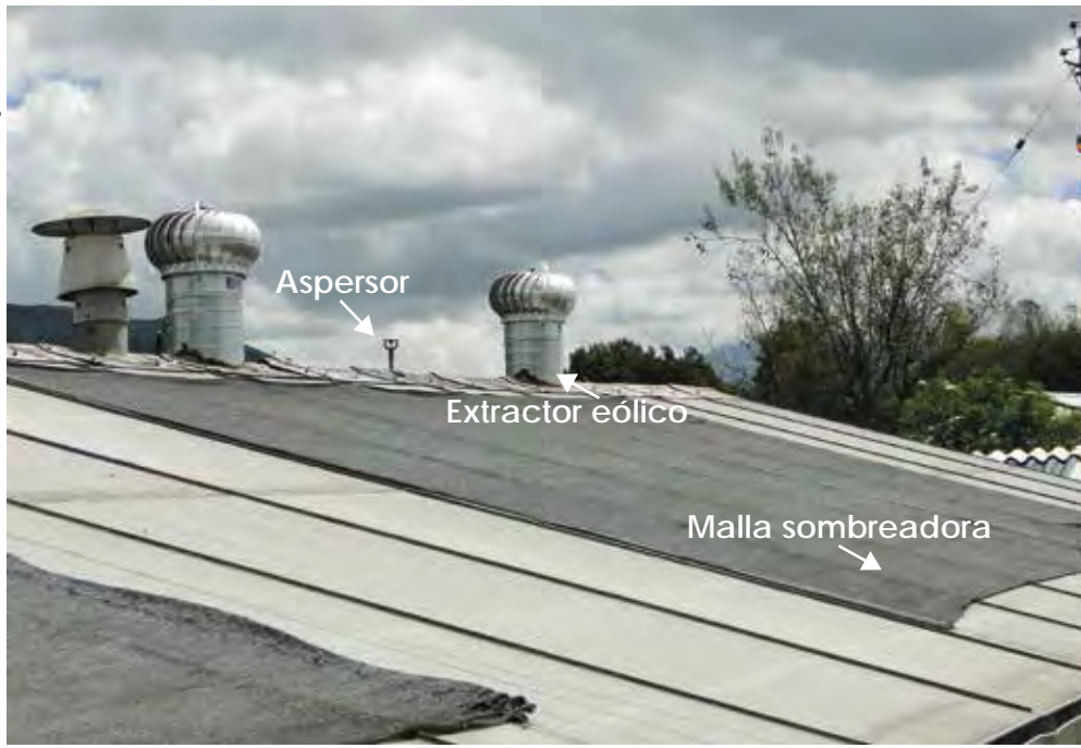
Mecanismos de control de temperatura colocados en el techo de la casa de malla de CIP-Quito, Ecuador.
