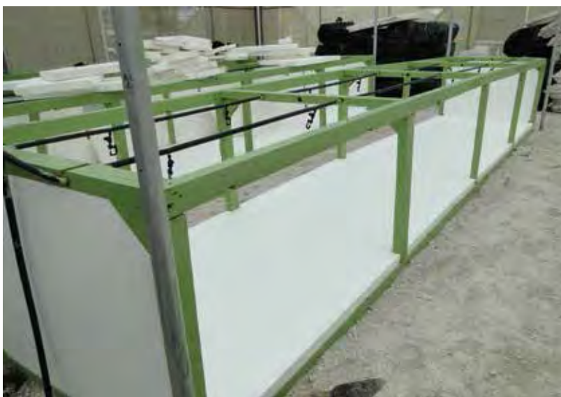
Colocación de láminas de aislante de 5 cm de espesor en la estructura de madera. CIP-Quito, Ecuador.
