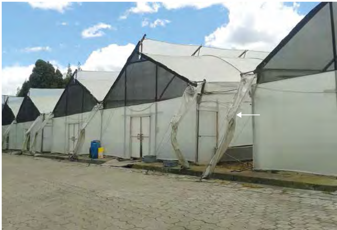
Anclaje de invernadero con cables de acero galvanizado usado para invernaderos de floricultura, Quito, Ecuador.
