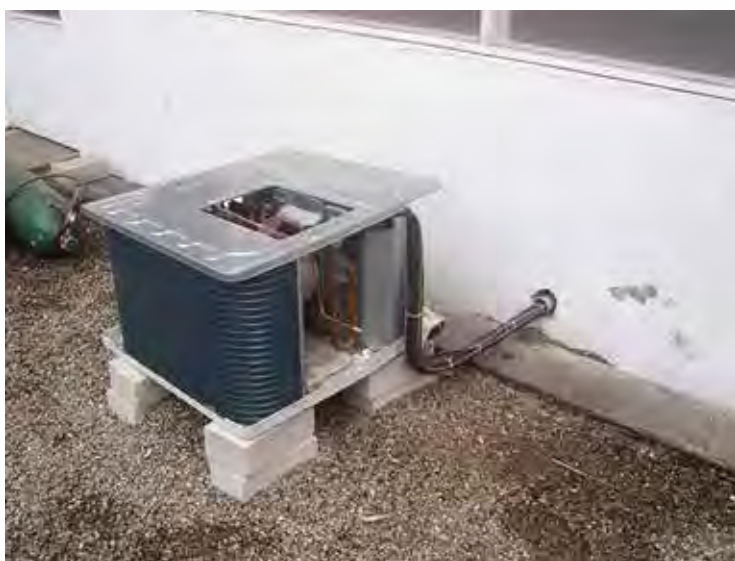
Unidad de enfriamiento (condensador y compresor).
