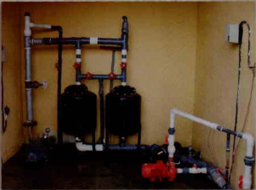
Figura 12. Instalación típica de unidad de filtrado (filtro de arena y filtro de anillos)
