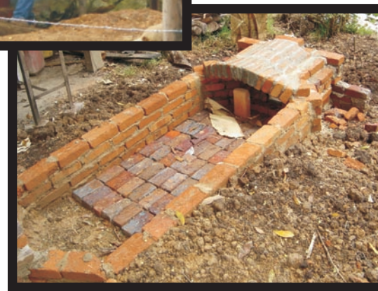
Conducto de gases ►
