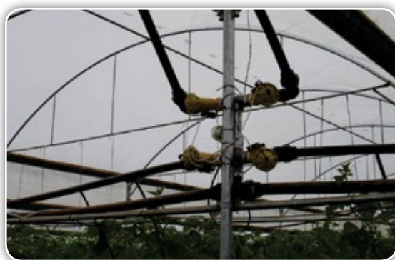
Figura 2.19. Tubería aérea de conducción de agua caliente para generar calor
