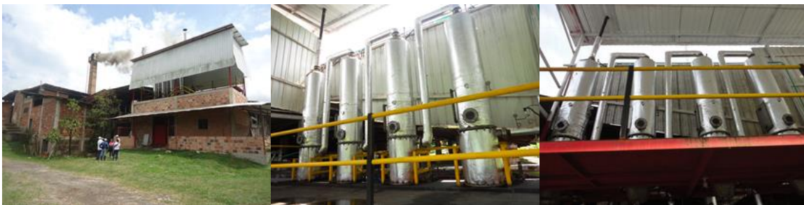
Figura 80. Evaporador múltiple-efecto para la producción de panela (hacienda Santa Bárbara, Suaita, Santander).
