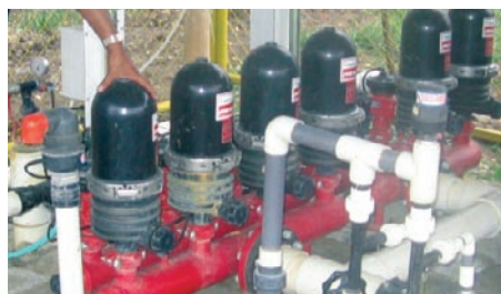
FIGURA 30. CONJUNTO DE FILTROS DE DISCOS.
