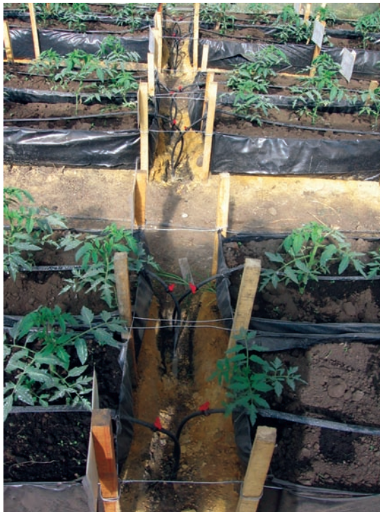
FIGURA 32. TUBERÍA MÚLTIPLE DE DISTRIBUCIÓN EN UNA NAVE DE INVERNADERO PARA TOMATE.
