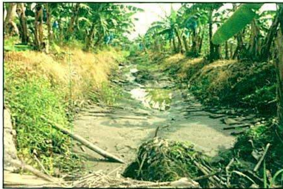
Figura 18. Sedimentación en canales de drenaje.
