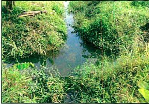
Figura 16. Obstrucción de la salida de agua, evidencia del deterioro generalizado de la red de drenajes.
