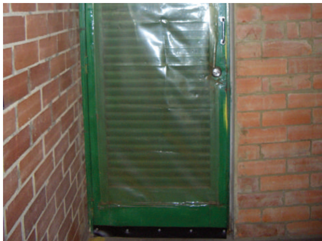
Figura 41. Puerta sin espacio.
