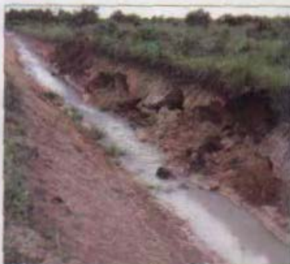
Figura 4. Canal de drenaje deformado por falta de talud en un sector arenoso del terreno de siembra.
