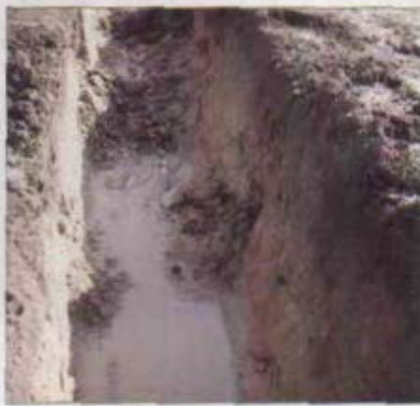
Figura 29. Canal sin diseño hidráulico
