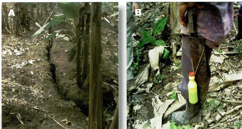
Figura 22. A. Construcción de drenajes internos en el lote; B. Desinfección de herramientas
