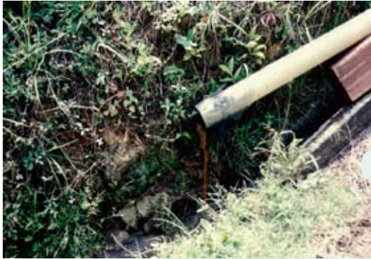
Desagüe con malla para capturar las brocas
